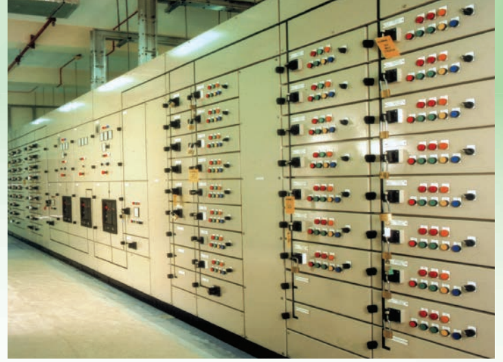
Low Voltage Switchgear المفاتيح الكهربائية منخفضة الفولتية
