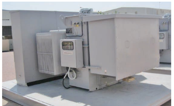
Package Substation المحطة الكهربائية المغلقة
