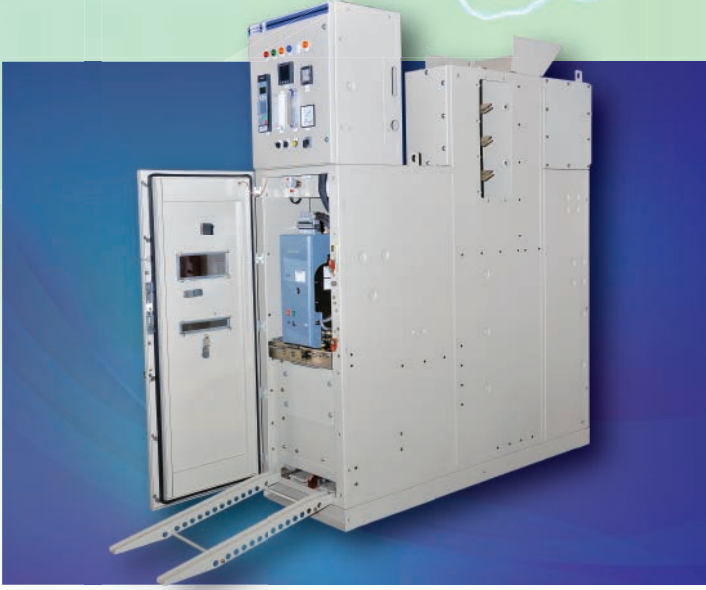
Medium Voltage Switchgear المفاتيح الكهربائية متوسطة الفولتية
